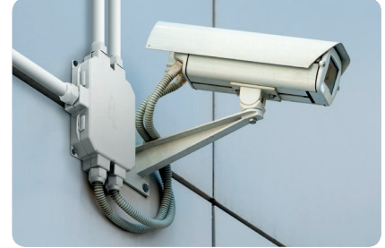
Aan de muur met kabels
